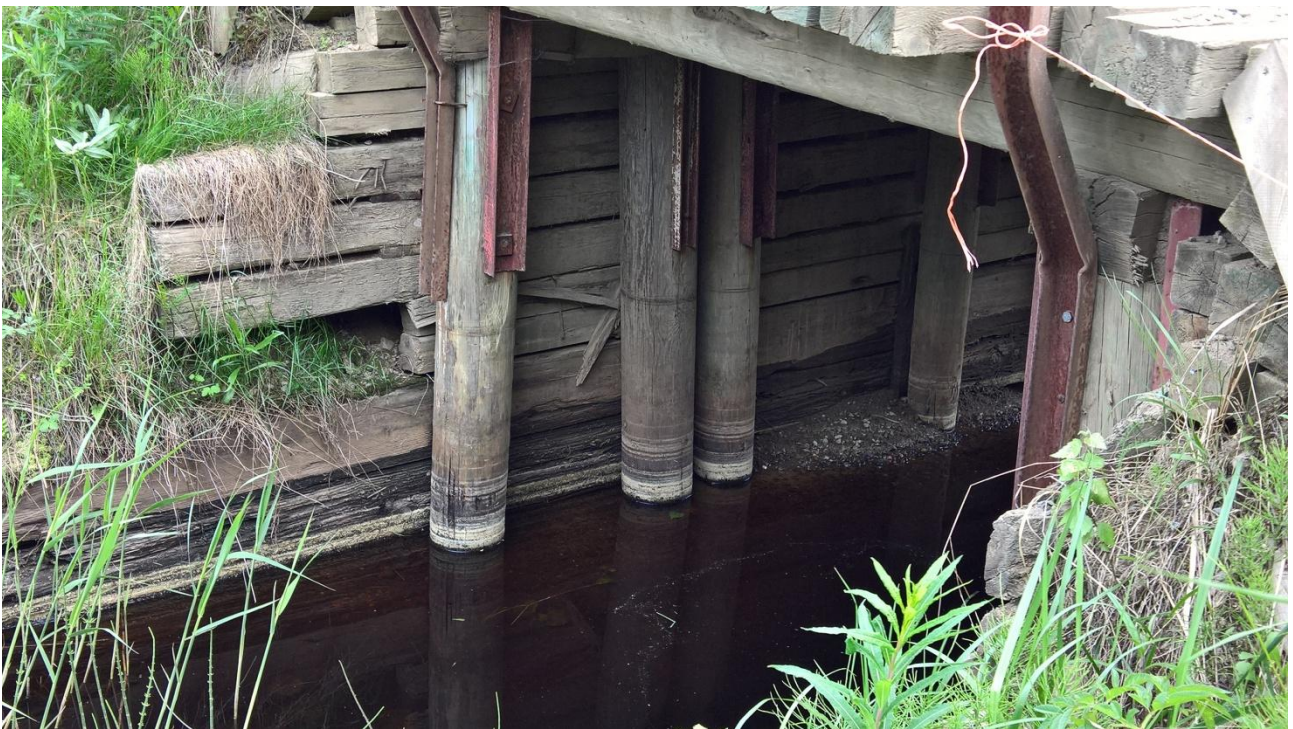
Sillan kehikkorakennetta on tuettu teräksillä. Siltarakenne ei täytä nykyisellään liikenteellisiä vaatimuksia.
